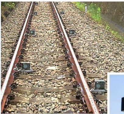
設置状況(無線式ターゲット)
